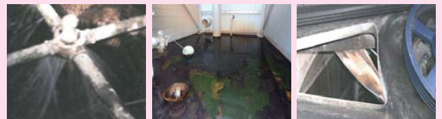
散水口の詰まり
